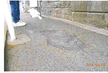
「道路の凹み、段差」 13カ所
