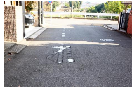
「止まれ」の表示が消えかかっている
